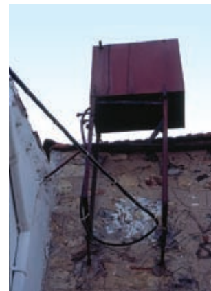
Ανεπαρκέστατη στήριξη ντεπόζιτου νερού (βάρους άνω του ενός τόνου) σε σχολείο Θεσσαλονίκης (2009).
