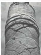
Ρωγμές στην καμινάδα.
