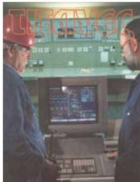
• Τεύχος 56 Οκτώβριος 1991 Σύστημα ελέγχου της παραγωγικής διαδικασίας, με ηλεκτρονικό υπολογιστή, στο Καμάρι.
