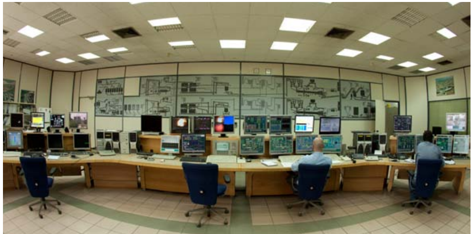
Η λειτουργία του εργοστασίου πραγματοποιείται μέσω του νέου πάνελ.
